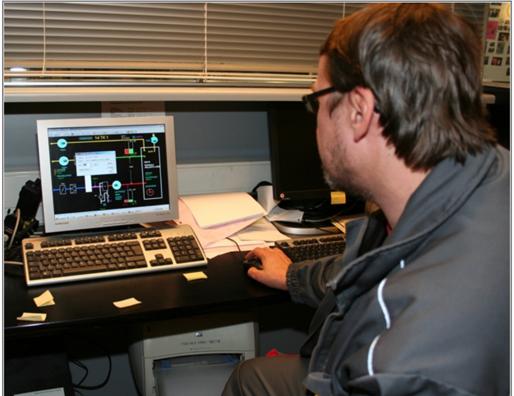
Toimitilakiinteistöissä rakennusautomaatio on tärkeässä roolissa valvottaessa ja ohjattaessa kiinteistön järjestelmiä. Rakennusautomaation toimivuus on yksi erikoishuollon vastuulle siirtyvistä asioista.
