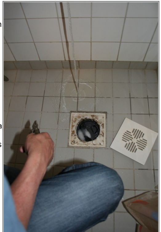
Takuutarkistuksessa katsottiin mm. viemärien vetoa. Yleensä veto-ongelmat selviävät puhdistamalla hajulukko.
