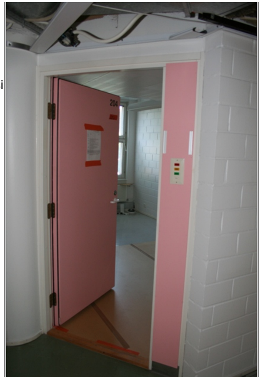
Sturenkatu 8:ssa oli panostettu äänenhallintaan jo terveysasemaa varten. Muuratut väliseinät ja hyvät ovet hyödynnetään jatkossa sosiaaliviraston terveysaseman tapaan yksityisyyden suojaa vaativassa toiminnassa.
