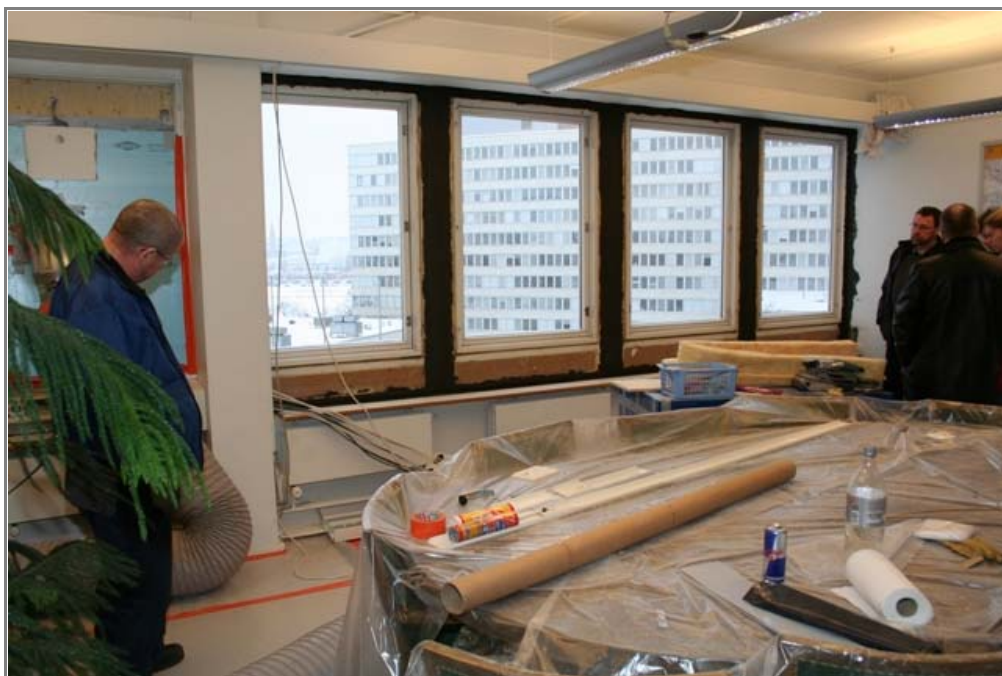
2. linja 7:n sisäseinään on lisätty eristettä, joka estää epäpuhtauksien pääsyn ulkopuolelta sisälle. Lisäksi menossa on julkisivuvaurioista aiheutuneiden kosteusvaurioiden korjaus. Työntekijät on sijoitettu 6. kerroksesta töiden ajaksi toisiin tiloihin.
