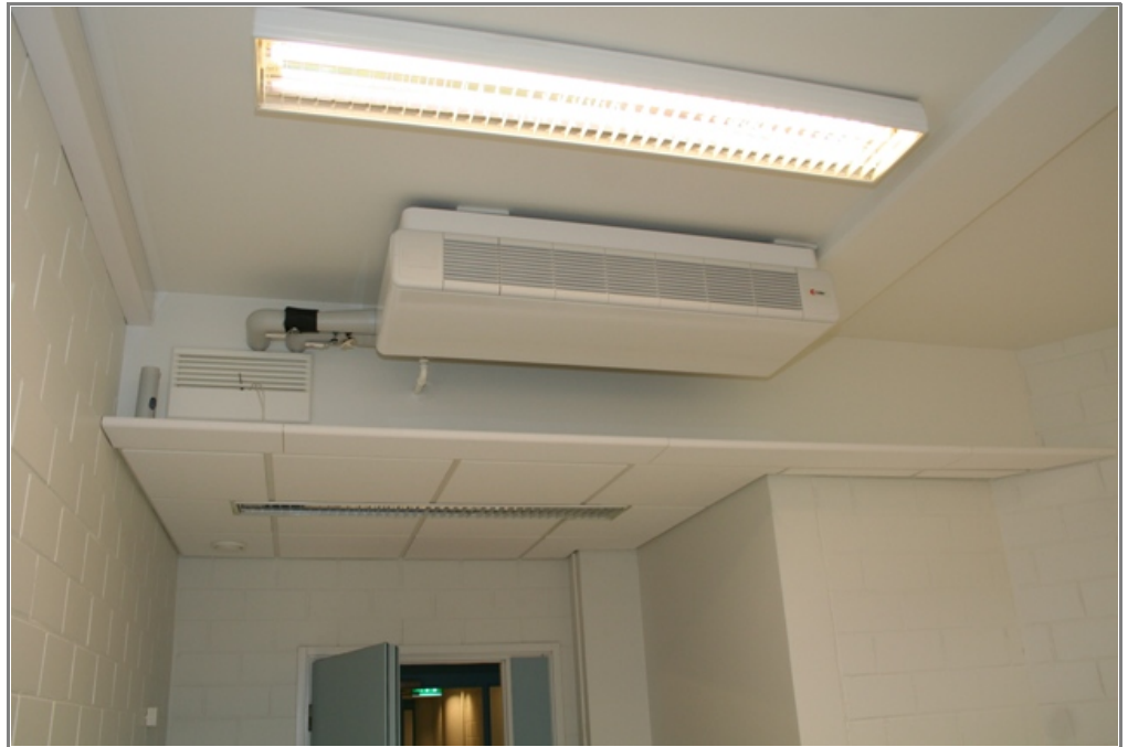
Sturenkatu 8:n työhuoneissa on nyt jäähdytys, johon energia otetaan Helsingin Energian kaukojäähdytysverkosta.
