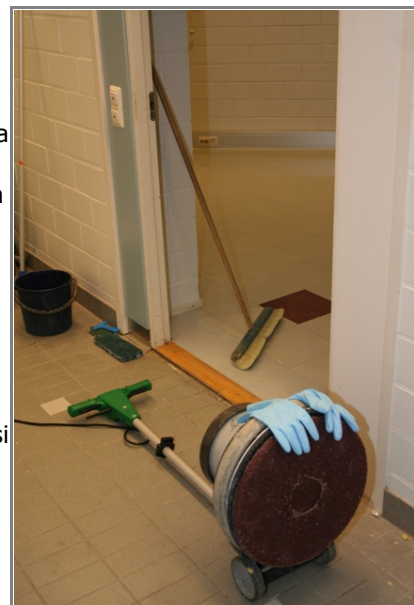
Sturenkatu 8:n rakennustyöt olivat marras-joulukuun vaihteessa päättymässä ja osassa tiloja oli jo tehty loppusiivous.
