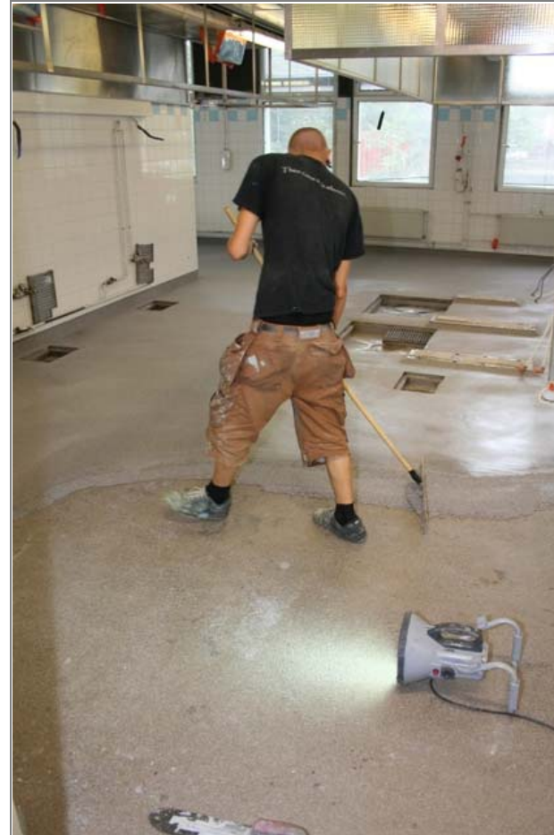
Pinnoitetta saatettiin tehdä vain pieni erä kerrallaan, ettei eri sekoituserien väliin tule näkyviä saumoja. Tässä on menossa pinnoitteen alkulevitys isolla pinnalla. Viimeistely tapahtui pienemmillä lastoilla.
