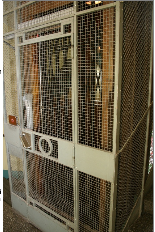
Hissejä on asennettu rakennuksiin jo 1800-luvulta lähtien. Esimerkiksi Helsingin Toimitilojen omistamassa Minervankadun asuintalossa on perinteinen veräjähissi, joka on nykyaikaistettu taloa remontoitaessa vanha ilme säilyttäen.
