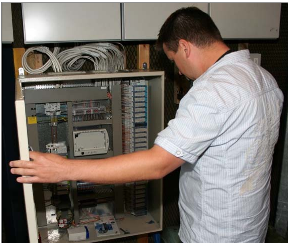
Jaahas, miltäs täällä näyttää, Marko Lukkari kurkisti iv-konehuoneen sähkökaappiin.
