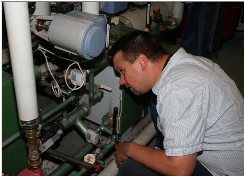
Siltasaarenkatu 13:n lämmönjakohuoneessa Marko Lukkari tutkaili mm. kaukolämmönsiirtimen toimintaa. Itse siirrin on uusittu muutama vuosi sitten eli talon tilanne on siinä mielessä kunnossa.
